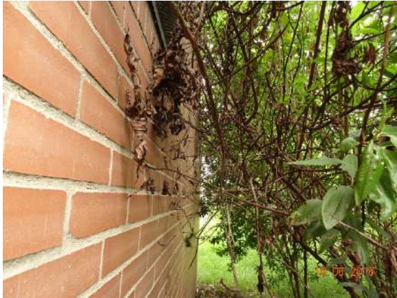
Foto 25. Afectación a la cobertura vegetal que se encuentran localizadas cerca al muro del conjunto Bora-Bora. Fuente: SDA-SER, 2016.
